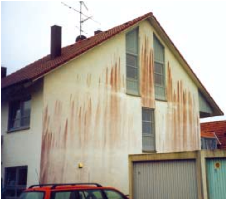
Bild 2: Eine Besonderheit: Rotalgen an einer Putzfassade. Geschossdeckenbereiche mit geringerem Befall.
