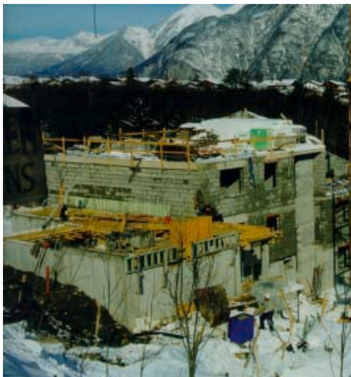
Die geografische Lage unseres Landes erschwert das Bauen: Regen und Schnee belasten Rohbauten erheblich. Die erforderlichen Austrocknungszeiten werden jedoch leider all zu oft ignoriert.
